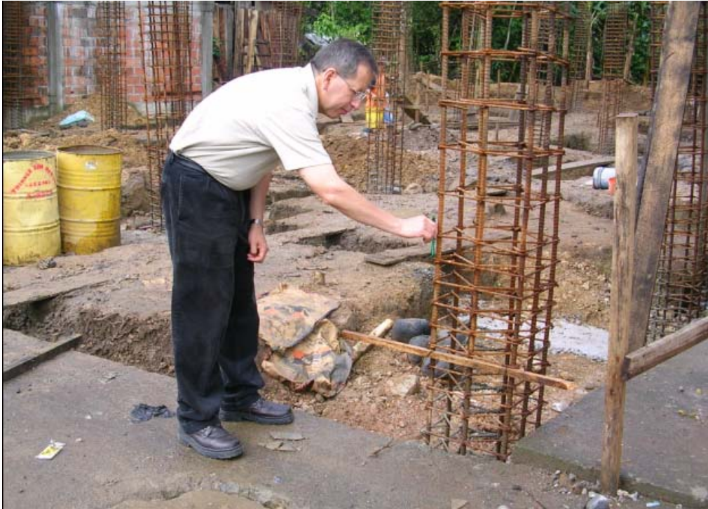
Fotografía 9.1 Detalle del armado de columnas en una estructura de la ciudad de Macas. 26-01-2006.
