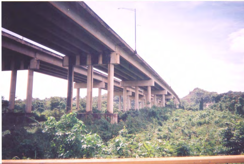
Figura 3.4 Vista hacia el noreste de las pilastras del Puente sobre el Río Indio
