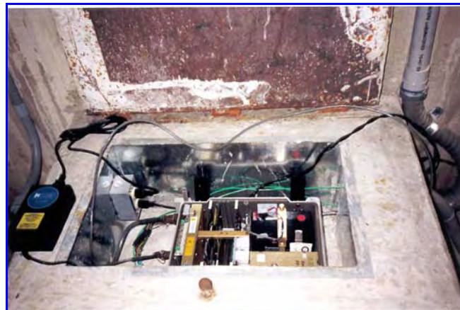
Figura 3.18 Vista del Altus K2 instalado
