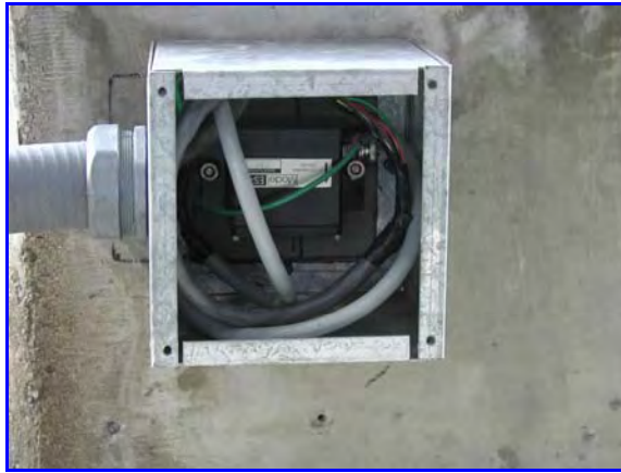
Figura 3.17 Vista del acelerómetro ES-U instalado
