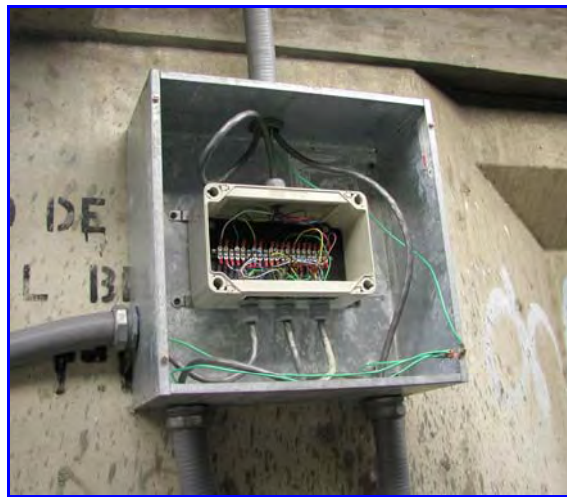
Figura 3.19 Vista de una caja de empalme instalada
